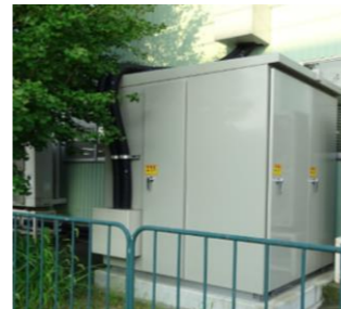
REキュービクル
