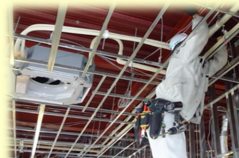
新築事務所 配線作業(加藤) 天井板を張る前に行う作業です。照明・コンセントや火災報知機などの配線工事を行っています
